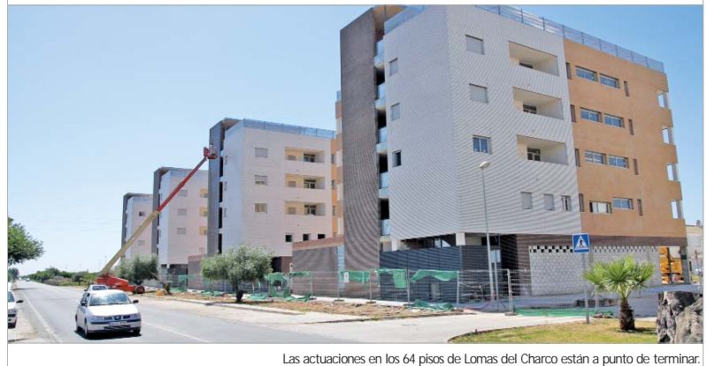
Las actuaciones en los 64 pisos de Lomas del Charco están a punto de terminar.
