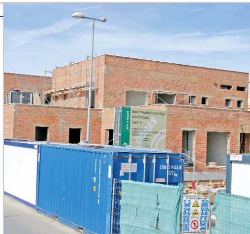
El nuevo centro sanitario sustituirá al actual en el núcleo de La Rinconada.
