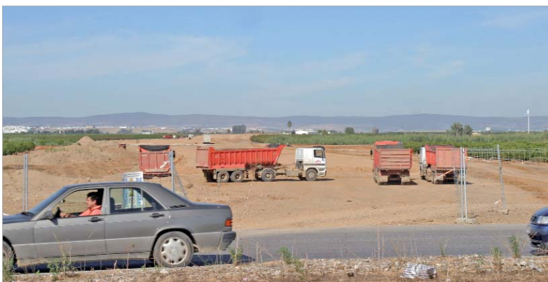
Los trabajos se han iniciado en la carretera que une La Rinconada con San José.
