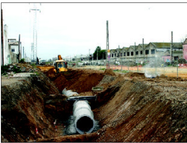
Los trabajos han comenzado por la urbanización de los terrenos del antiguo apeadero de Renfe situado en las traseras del barrio de San Jerónimo.
