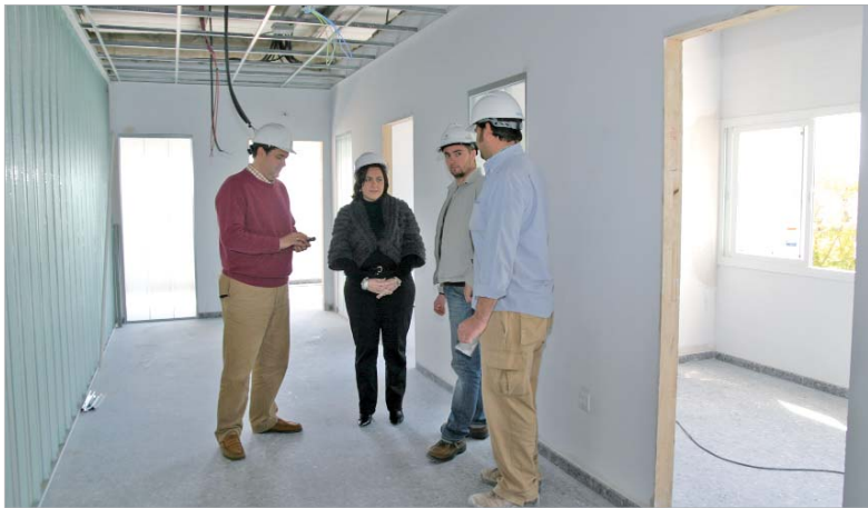
La delegada de Desarrollo Local, Pilar García Extremera, visita la evolución de las obras.
