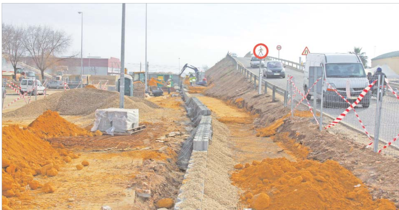
La ampliación del puente ya está en marcha y se espera que esté finalizado para el próximo año.
