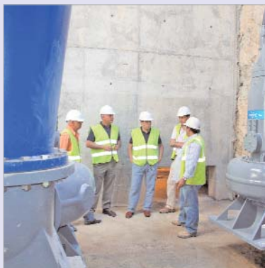
Javier Fernández observa el estado de las bombas centrífugas.
