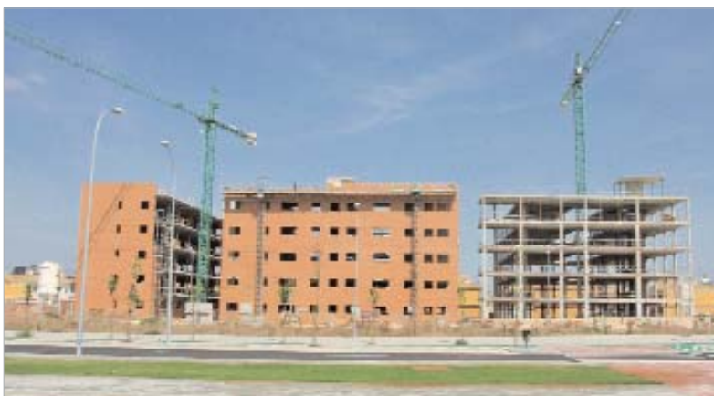
En estos momentos se ejecuta el cerramiento exterior de los bloques para poder trabajar en la distribución interior.
