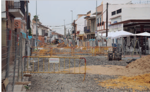
Obras en pleno desarrollo en la calle María Auxiliadora de La Rinconada.
