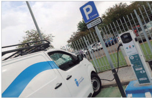
El primer cargador de vehículo eléctrico dispuesto por el Consistorio.
