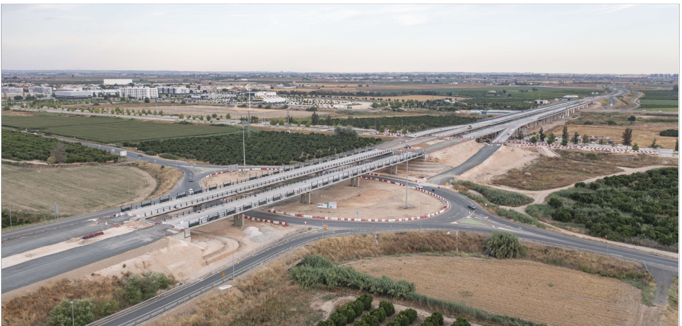
Vista aérea del avance de las obras del Viaducto, que salvará en altura los suelos de La Unión, acercando a La Rinconada y todo el arco norte de la provincia a la capital.
