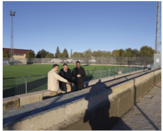
Las obras de las gradas del campo de fútbol 7 de Nuevo Ramos Yerga.
