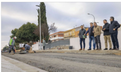
Javier Fernández, en la última visita a las obras de los accesos a la piscina.
