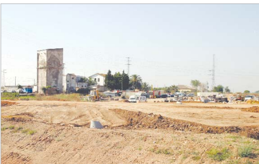
Imagen de las obras que se están ejecutando en El Cádiz III.
