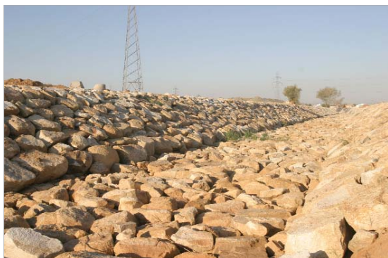
Obras en el arroyo Almonazar a su paso por El Cañamo III.
