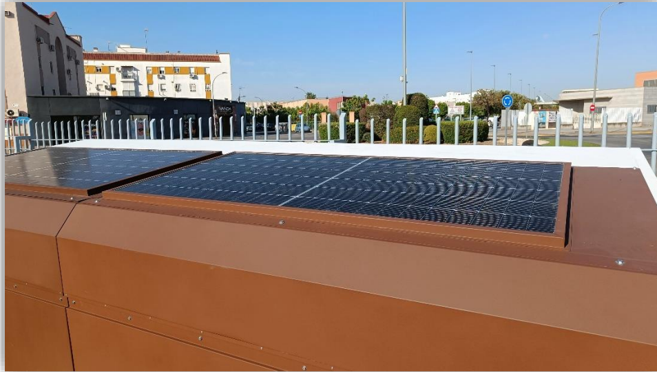
10. PLACAS FOTOVOLTÁICAS EN LA CUBIERTA DEL MÓDULO JUNTO A LA PISCINA CUBIERTA
